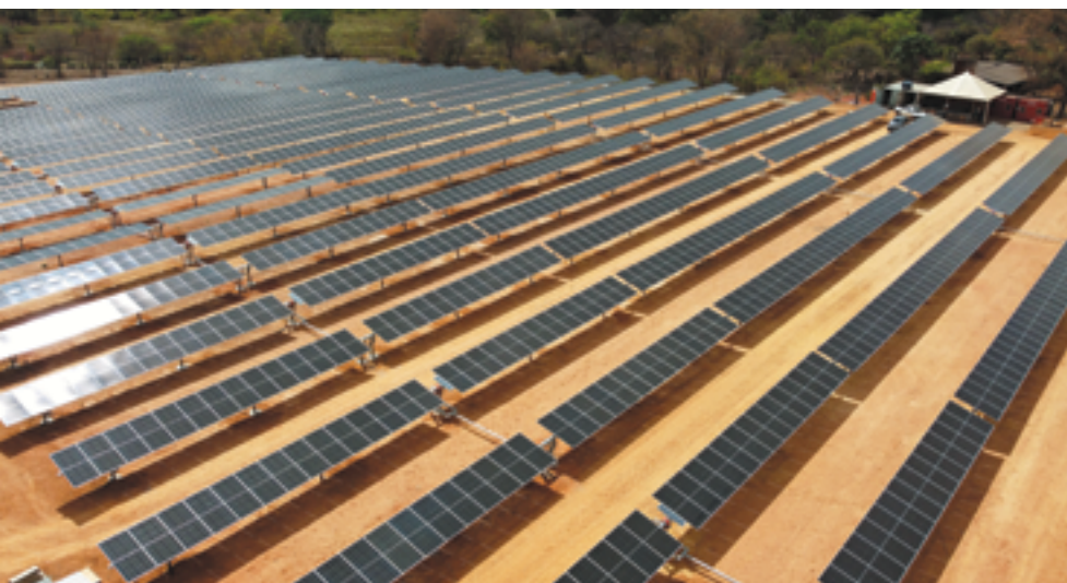
Usina solar da Evlua Energia em Montes Claros: atualmente, a empresa administra 127 parques como este
